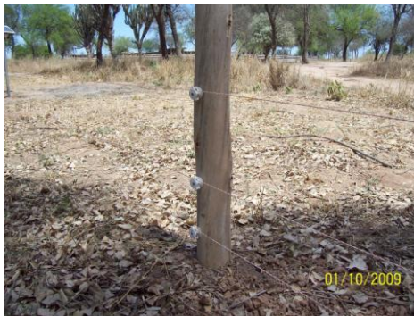
Imagen 27: Poste para instalación de alambrado eléctrico.
