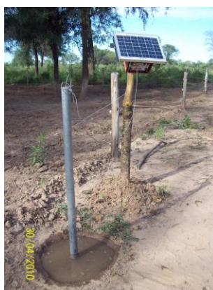
Imagen 30: toma a tierra junto al boyero solar.
